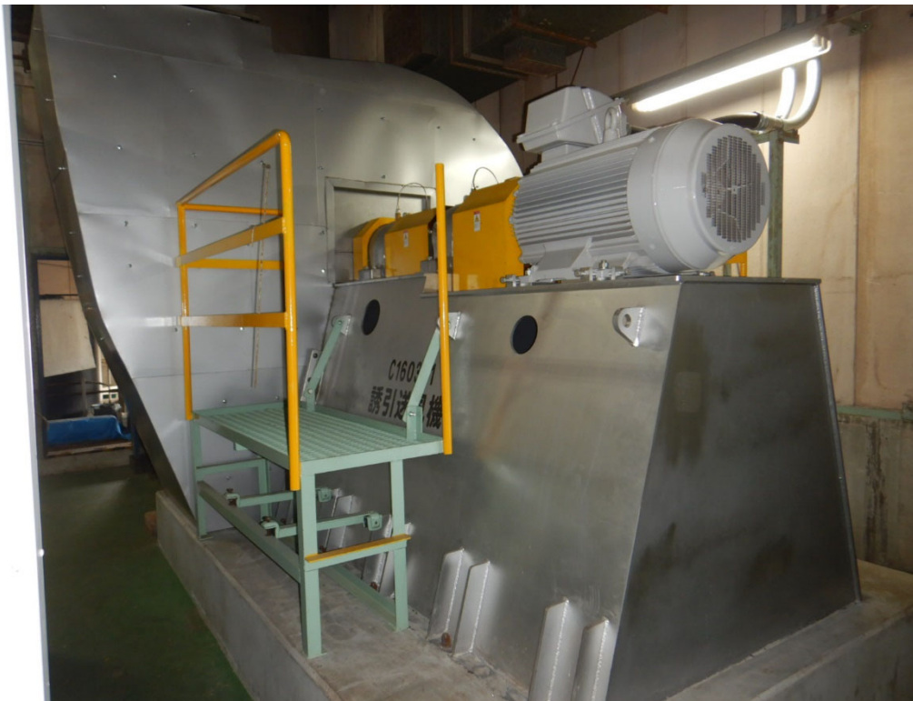
誘引送風機（令和5年3月撮影）
