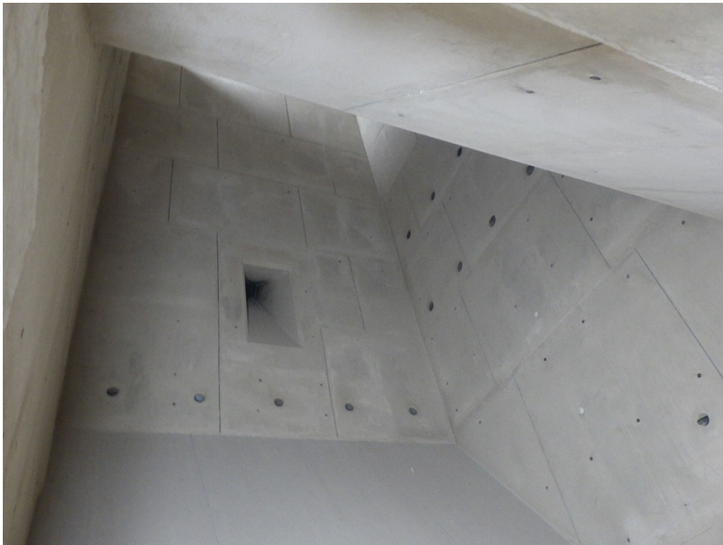
1系焼却炉内部（令和5年1月撮影）
