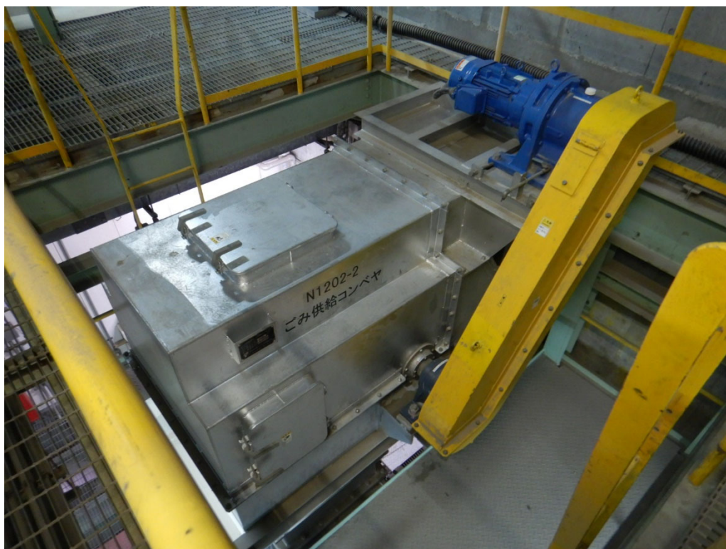
ごみ供給コンベヤ（令和4年3月撮影）
