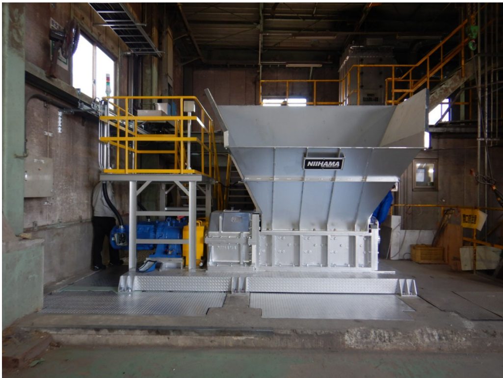
粗大破碎機（令和4年2月撮影）
