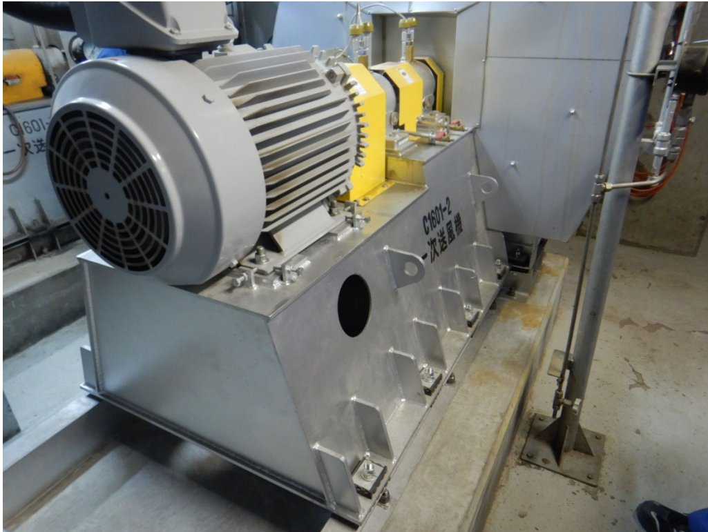
一次送風機（令和4年3月撮影）
