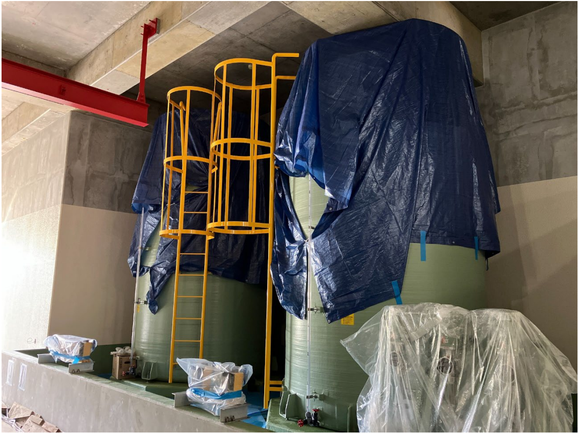
1階薬品ヤード（令和7年3月撮影）
