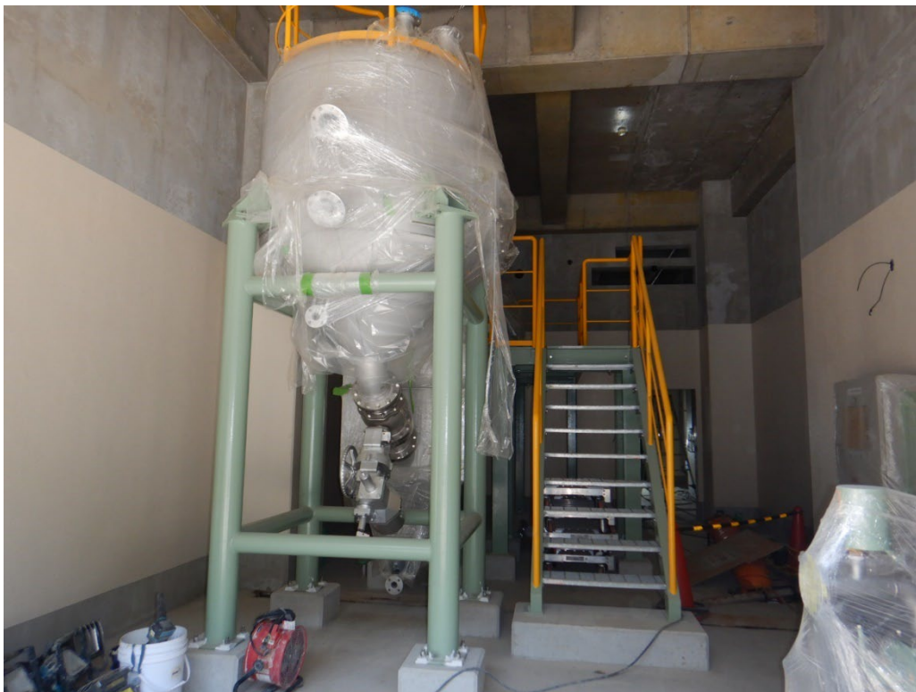
1 階沈砂除去装置室（令和 7 年 3 月撮影）
