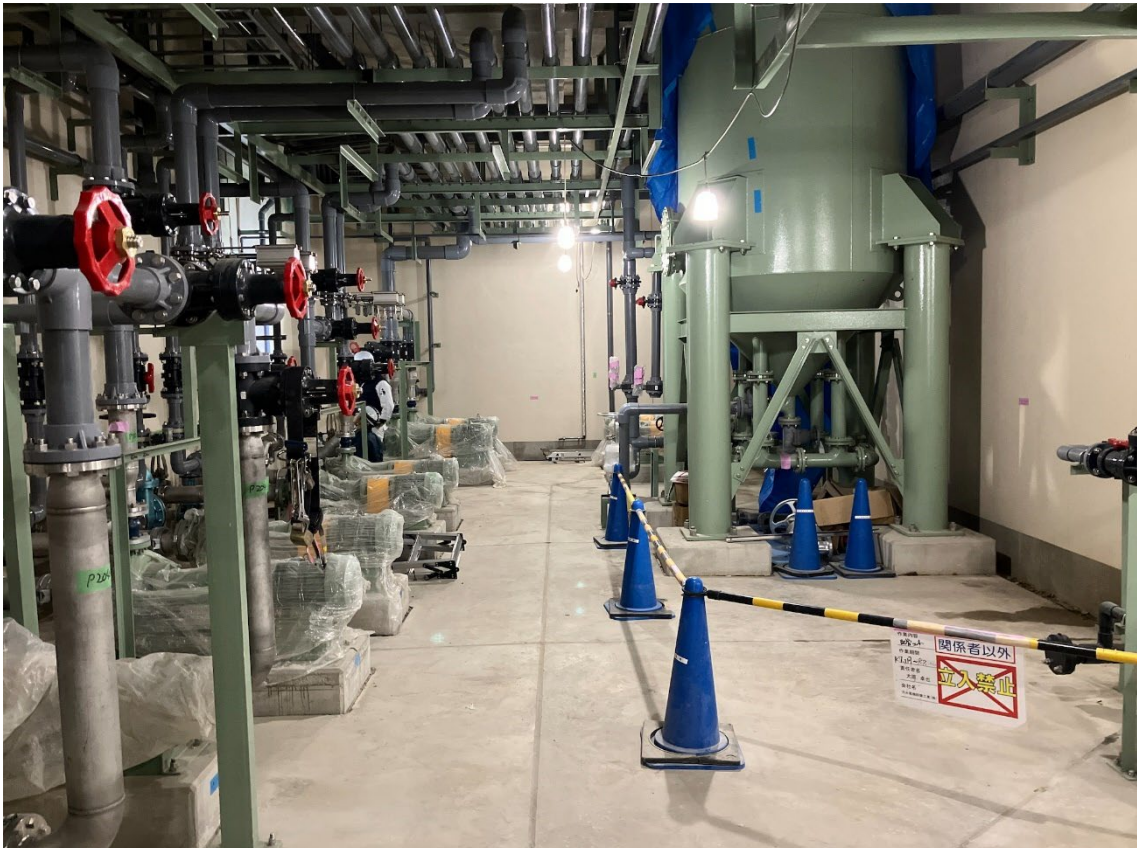
地階ポンプ室（令和7年3月撮影）
