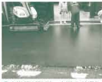
●水道管が破裂。水道の老朽化対策も深刻です 2月19日 広川町昭和通
