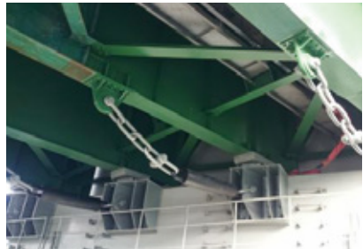
▲検査偽装・強度不足が判明した有田川にかかる高速道路橋の落橋防止装置（有田川町田口）
