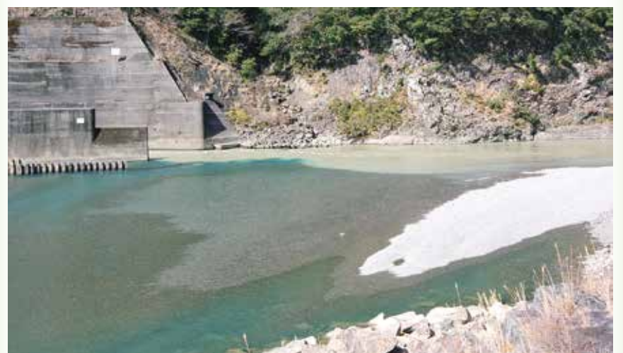
発電所放水口からの濁水
